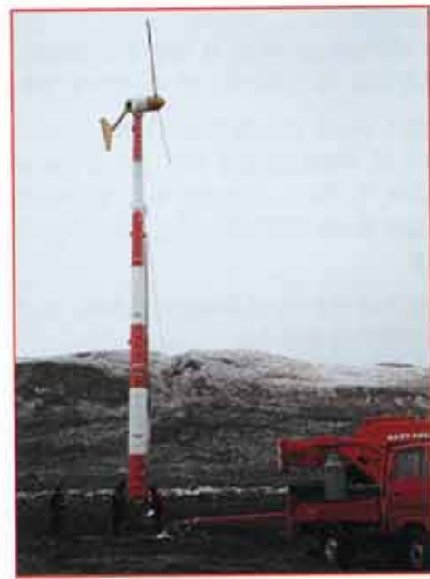
▲▲ 남극 세종기지에 설치된 10kW급 풍력발전기 ▲ 풍력발전기의 설치모습
