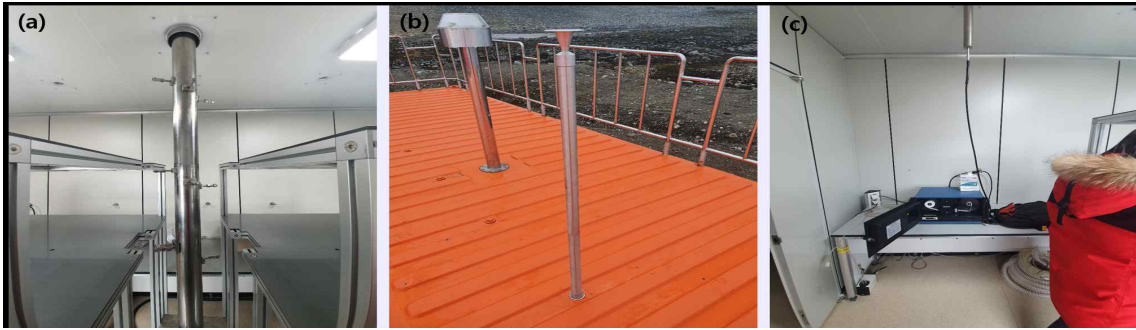
Fig. 3.4.32. 에어로졸 분석실 내부에 설치된 (a-b) 에어로졸 물리 관측장비용 인렛 내외부 및 (c) 블랙카 본 농도 측정용 장비
