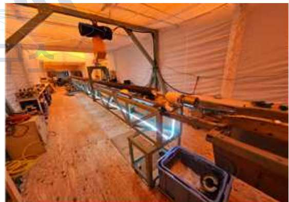
<시추기 마스트 LED 조명 설치>
