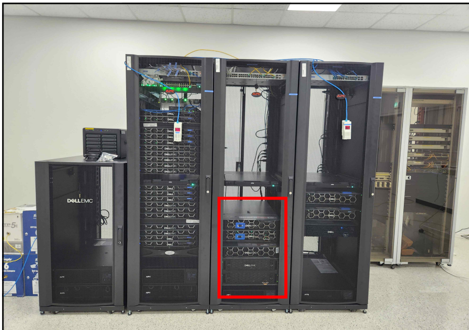
< 극지연구소 극지환경재현실용화센터 2F 데이터서버운영실에 위치한 백업 시스템 (빨간색 사각형에 백업 서버 및 스토리지 장비 위치) >
