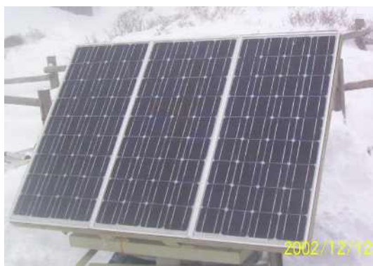
<한라산 윗세오름 기상장비 전원공급용 솔라판>
