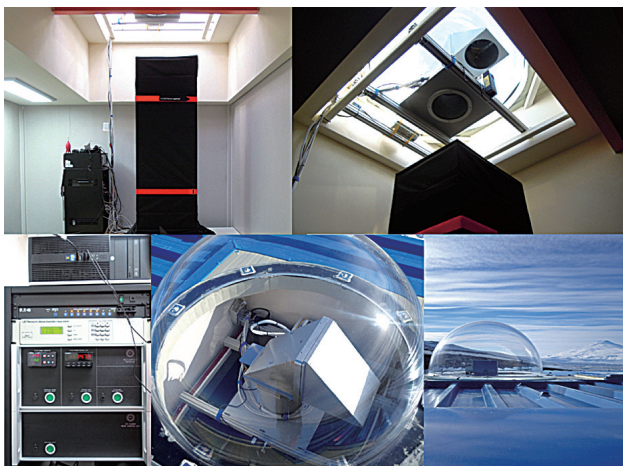
우주기상관측동에 설치된 FPI와 천정돔.
