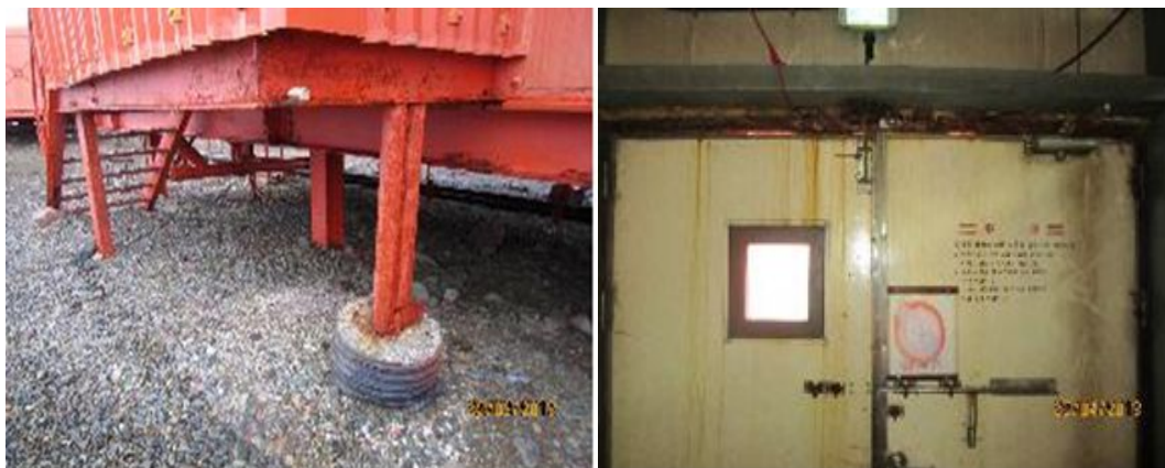
그림 1-4. 극심한 부식 환경에 노출된 남극세종과학기지 건축물
