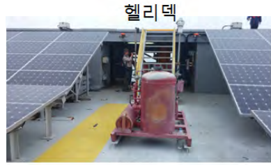
8층 헬리덱 아래 태양열 전지 패널 아래에 설치
